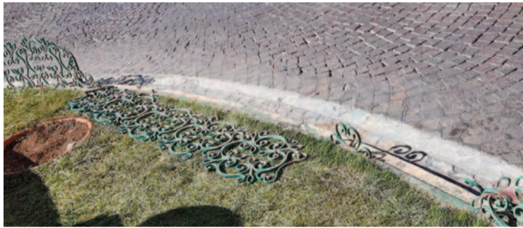
● La recinzione della fontana danneggiata
